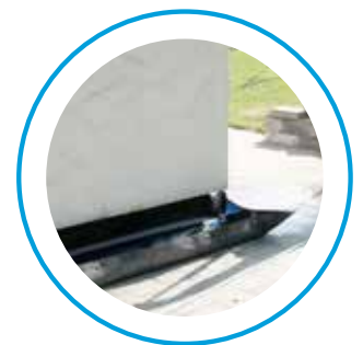
Das Abwasser wird mit Auffangwannen aufgefangen.
